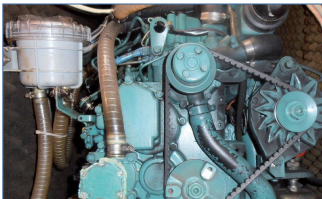
Fig. 3 - La cinghia di trasmissione del motore (a destra) non deve sfarinarsi, né essere indurita, né slittare durante il moto. In alto a sinistra il filtro dell'acqua.
